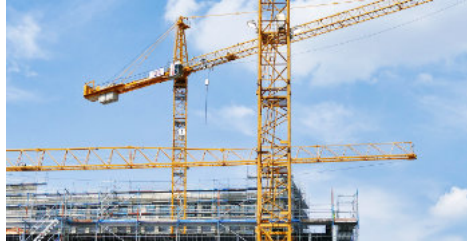
Grundsanierungen kosten rund 70–80 Prozent vergleichbarer Neubaumaßnahmen, gehen jedoch oft mit funktionalen Kompromissen und dauerhaft höheren betrieblichen Folgekosten einher. © SatyaPrem – pixabay
